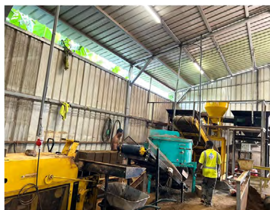
Nouvelle presse manuelle de l'entreprise DIPAK (haut) ©DIPAK. DIPAK a reçu sa nouvelle ligne de production semi-automatique. Elle est en cours d'installation. Unité de production semi-automatique de l'entreprise ACBTP (bas) ©ACBTP.
