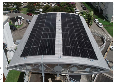
Générateur solaire en autoconsommation et mobilité électrique. Maître d'œuvre : Région Guadeloupe (Espace Régional du Raizet) ; Maîtrise d'œuvre : BET DAC-EQUINOXE-ITEC. Réalisation : OMEXOM.
